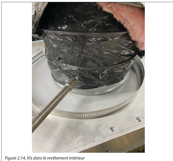
Figure 2.14, Vis dans le revêtement intérieur
